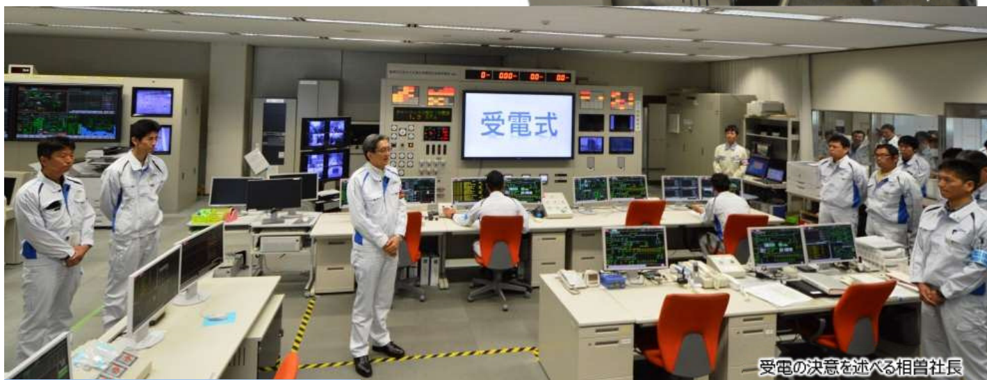
三沢技術部長によるCO 2 分離回収設備の受電操作
