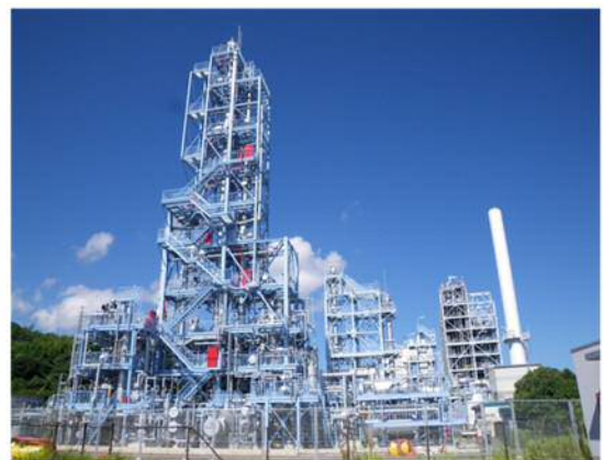
電源開発若松研究所の物理吸収法実証試験プラント (出典: 電源開発) ※本事業は若松研究所での試験成果を反映
